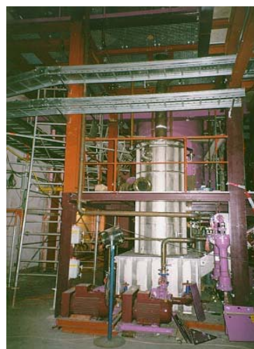
Rys 16. Widok zew. reaktora wysokotemperaturowego [30].
