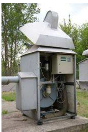
Rysunek 32 Stacja ASS-500. Widok wnętrza stacji. Stacja znajduje się na zewnątrz budynku CLOR. Źródło: www.badania-nieniszczace.info
